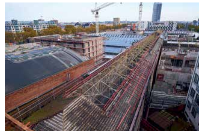
Vue sur les structures temporaires et les travaux de rénovation en toiture.
